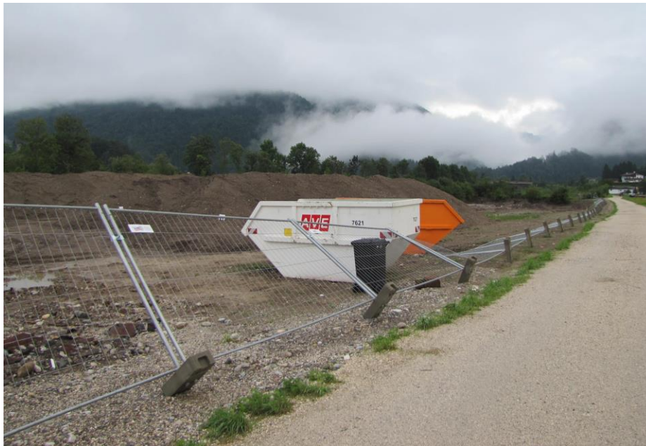
Abb. 51: Von Starkwind umgelegter Bauzaun (4. August 2014)
