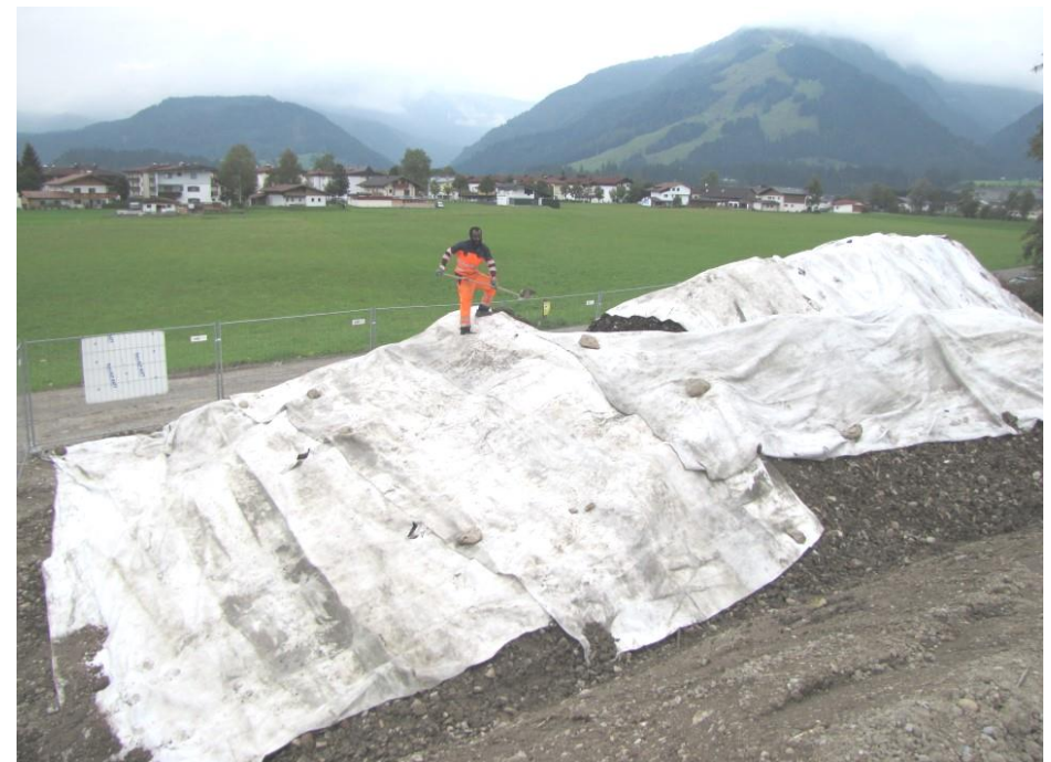
Abb. 26: Vor Niederschlagseintrag geschützte Mittelkornmieten 17
