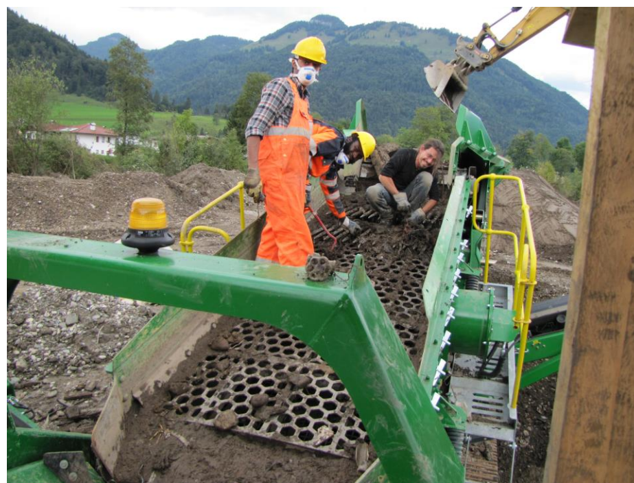
Abb. 19: Reinigungsroutine am Rüttelsieb (19. August 2014)
