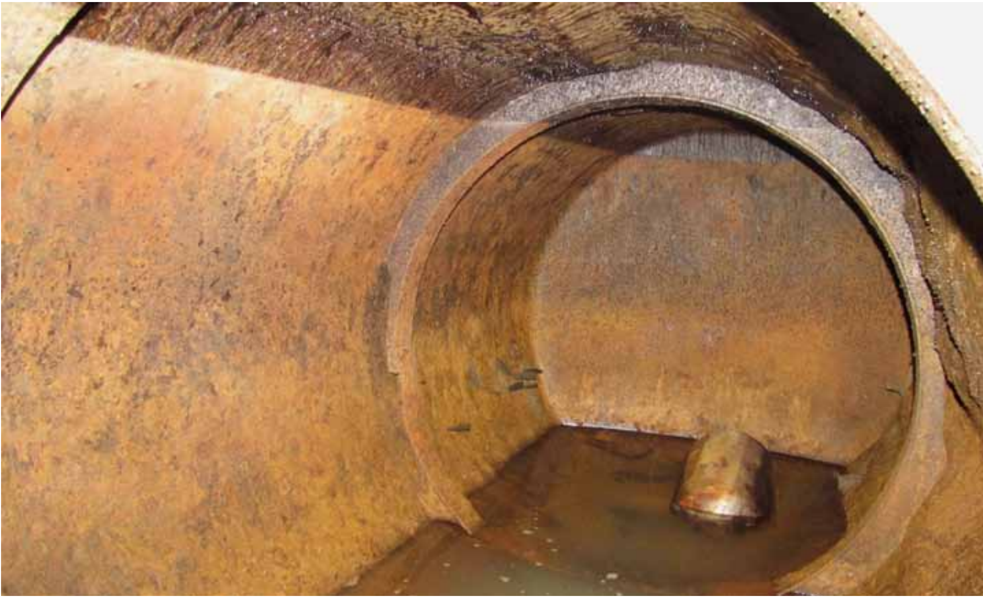
Die »Riesenkrake« bei der Erstinspektion, ...
